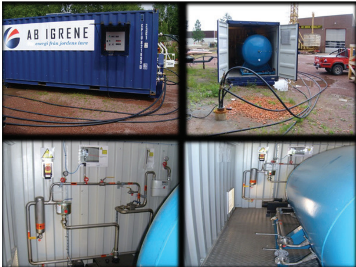
Figur 17 Igrenes avgasningsanläggning. Källa: Igrene
